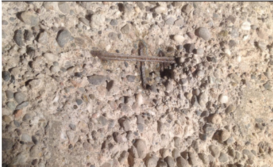
„Эффект эрозии бетона“, вызванный действием агрессивных кислот, содержащихся в смеси-источнике биохимического газа
