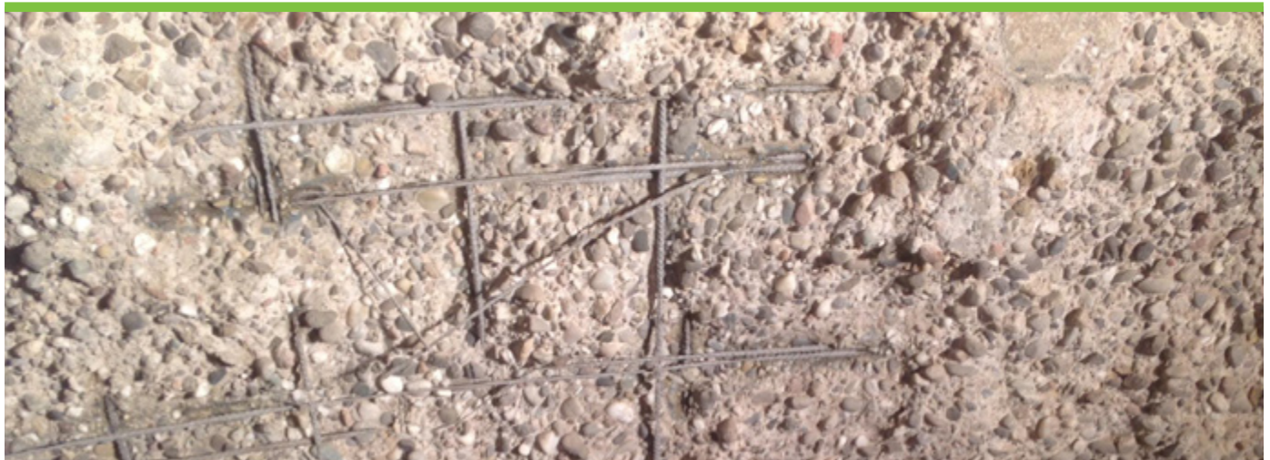
Интенсивная эрозия бетона, вызванная биогенной кислотной коррозией (BSK)
